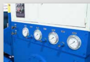
控制中心 Control center
